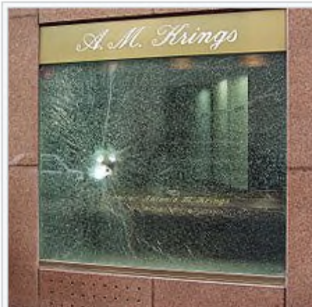
Panzerglas-Schaufenster eines Juweliers nach einem Einbruchversuch.
